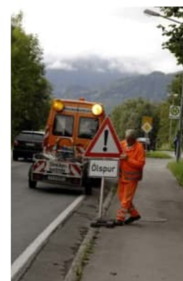
Mit Hinweisschildern wird der Verkehrsteilnehmer auf Gefahrenstellen hingewiesen, die nicht sofort beseitigt werden können. © Staatsbauverwaltung
