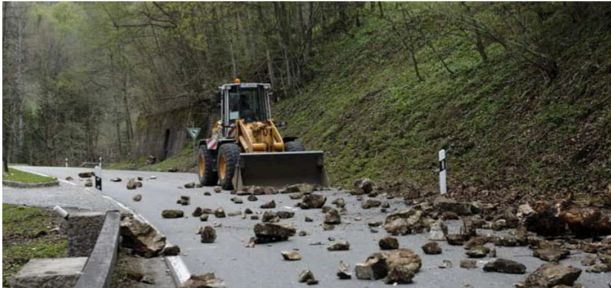
Aufräumarbeiten nach einem Felssturz © Staatsbauverwaltung
