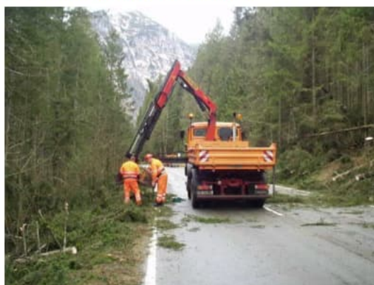
Nach einem Unwetter muss die Straßenmeisterei die umgestürzten Bäume und heruntergefallenen Äste beseitigen. © Staatsbauverwaltung
